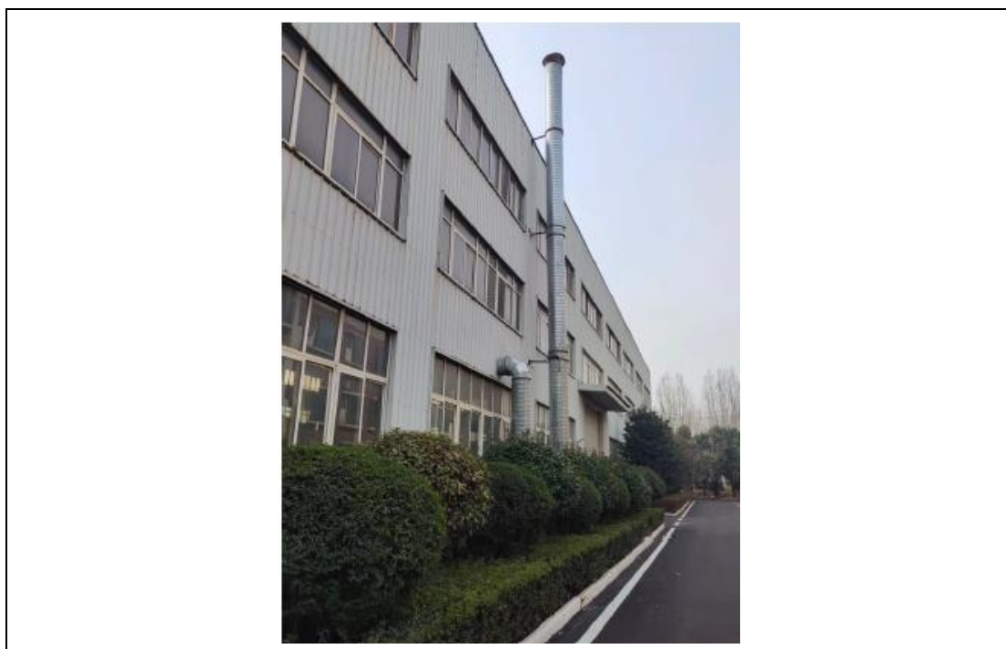
图 4 焊接烟尘除尘器排气筒
